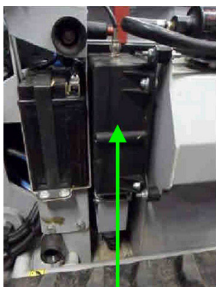
前方左側の NBB コントロールボックス
